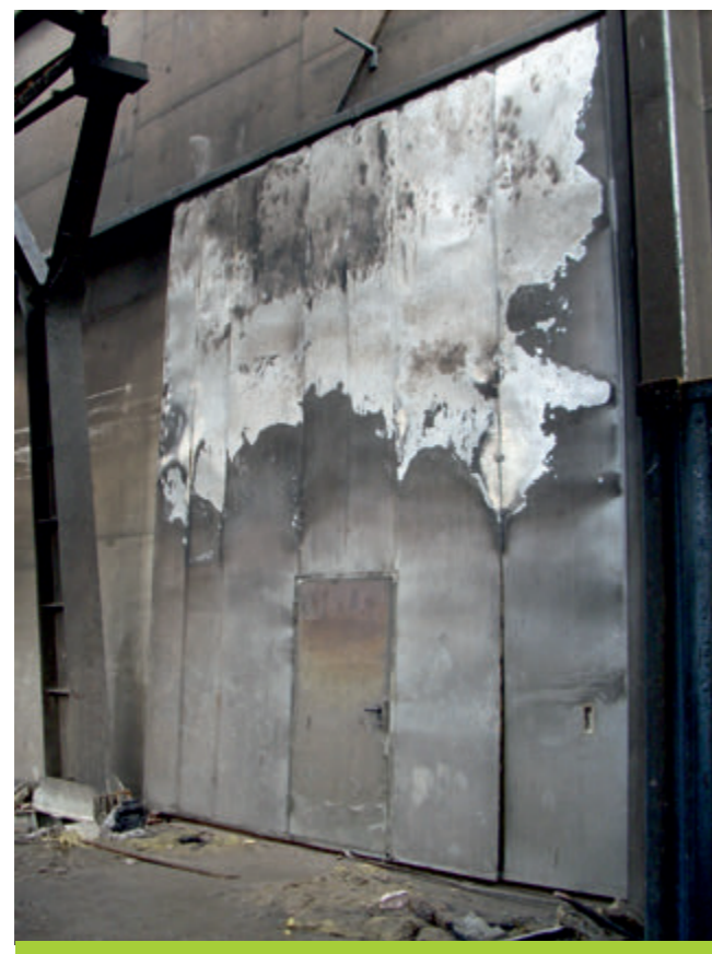
Внутренняя сторона ворот после пожара The gate from the fire side
